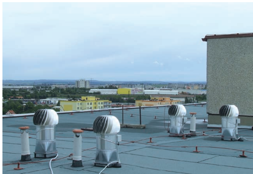
12 ks hybridních ventilátorů HV14 bylo instalováno v Praze, ul. Makovského
